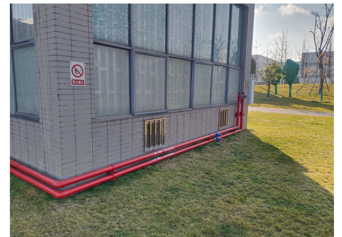
安全生产办公室整改
